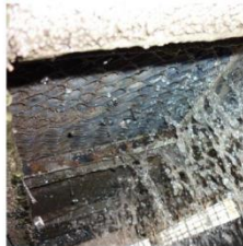
30/Marzo/11. Torre de enfriamiento
