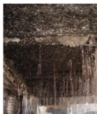
3/Junio/10 Torre de enfriamiento
